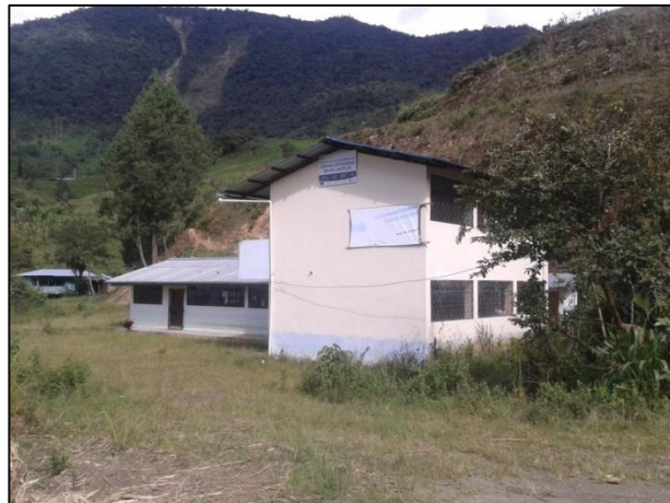
Foto 10. Centro Artesanal Valladolid, abandonado y sin uso alguno
