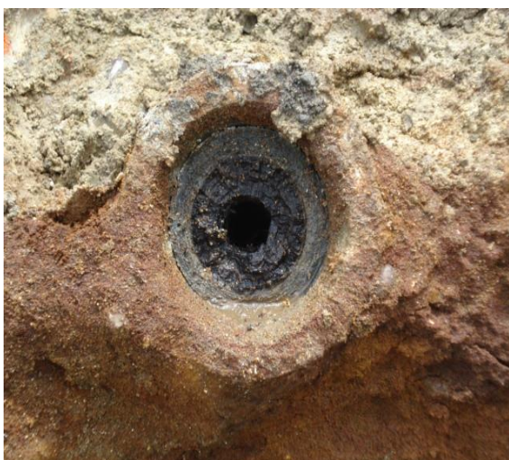
Foto 2. Acumulación de manganeso alrededor de la tubería de asbesto cemento.
