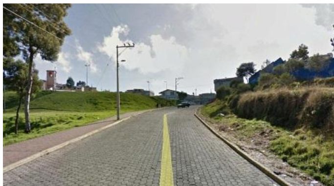
Fotografía 21.- Estado Actual de la calle 21 de agosto
