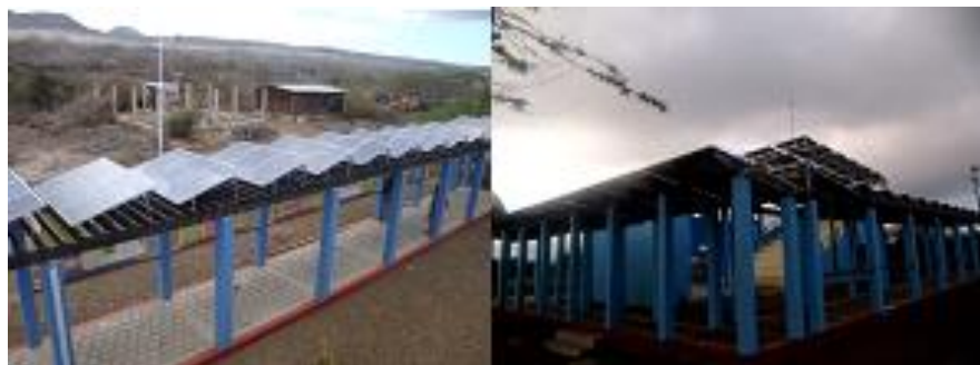
Gráfico 9. Sistema Fotovoltaico Rehabilitado. Fuente: MEER, 2015
