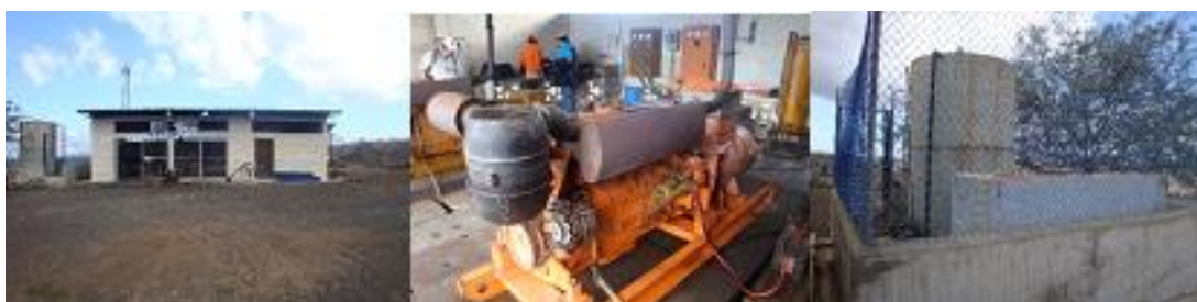
Gráfico 6. Grupos Térmicos, Sistema de Almacenamiento y Central Térmica antes de la Implementación del Proyecto Fuente: MEER, 2009
